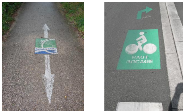
Exemples de marquage au sol. Le passage fréquent de véhicules motorisés impose un entretien régulier et rigoureux
