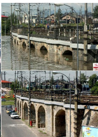
Illustration 17 : Inondation de la ville d'Usti nad Labem par l'Elbe (viaduc ferroviaire ligne Ustecko-Teplice) au nord ouest de Prague en 2002. Source CETE Île-de-France.
